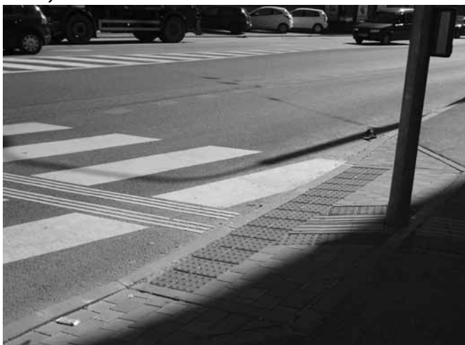
Priechod pre chodcov s bezbariérovým prístupom na vozovku. Označený signálnym a vodiacim pruhom, aj tlačidlami s ovládačom v prijateľnej výške.
